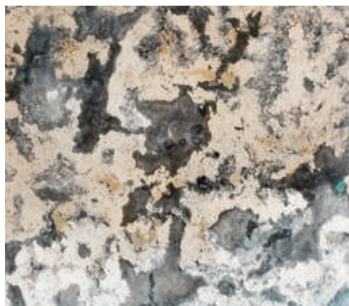
HONGOS Y MOHO
