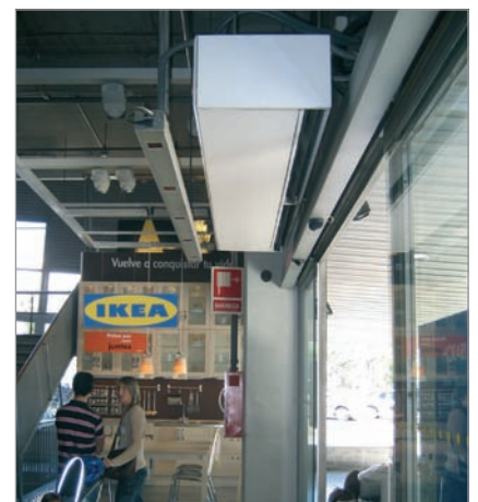
Windbox Instalación vista en hipermercado
