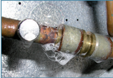
Figura 18: Burbuja que indica una fuga
